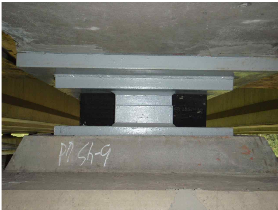
받침장치 전경 (가동단)
